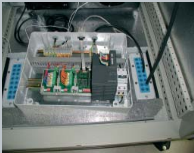
Intercambiador de calor (en negro), caja de control y pasacables estanco. © GRANTECAN.
