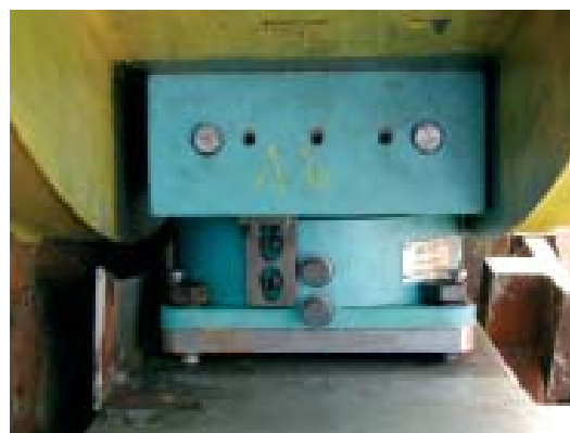
Cojinete del GTC en el eje de elevación © GRANTECAN
